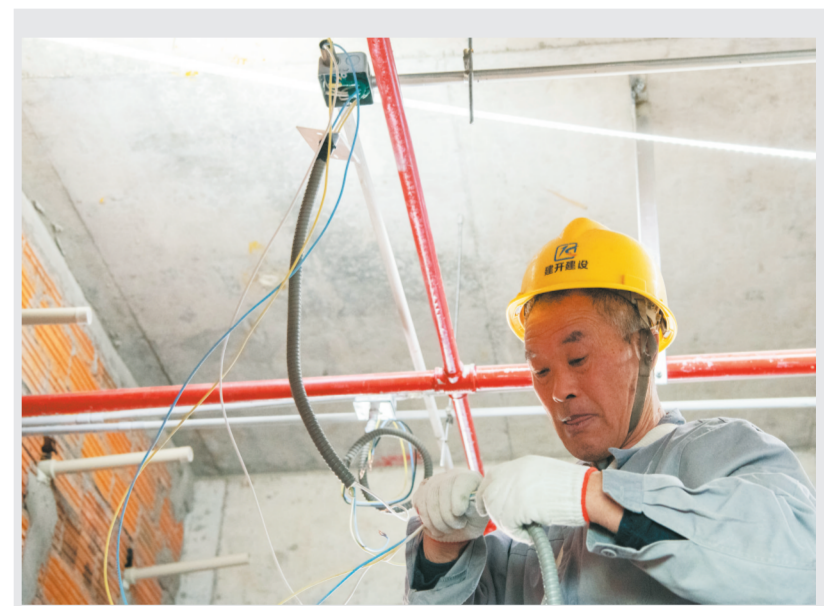
双凤经开区颍泉路幼儿园项目正在进行外墙面及室内装饰施工,计划今年秋季学期招生。安心托幼行动是安徽十大暖民心行动之一。2023年全县计划新建幼儿园12个,新增托位974个,着力解决托育难、入园难等问题。(记者 陈忠 通讯员 刘明俊)
