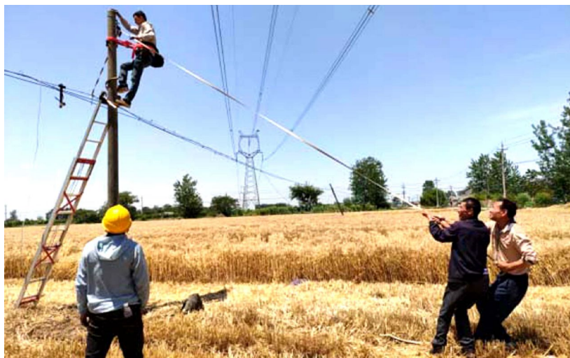
6月7日,在室外最高温度达30度的情况下,流均文电站线路维修员对二桥村姜庄光缆线路进行维修。现场通过光缆检测仪沿线进行检测,结果发现明处断线3处,暗处断线2处,沿线检查线路近10公里,其中架设电杆2根,经过6个多小时的维修,换光缆线600多米。 李宣璐 摄
