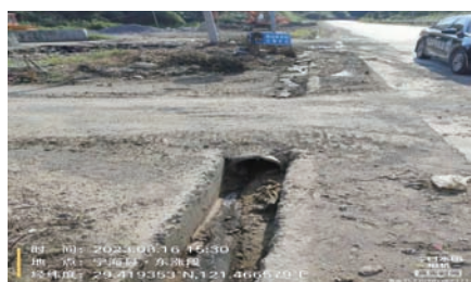
垃圾场站废水经沟渠流入河道
