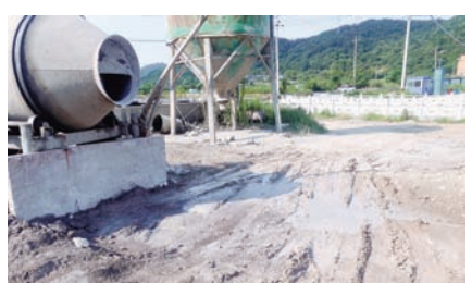
搅拌站碱性废水直排外环境
