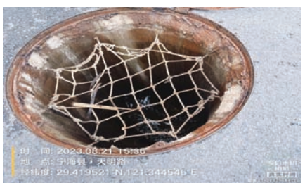
大量雨水流入污水井
