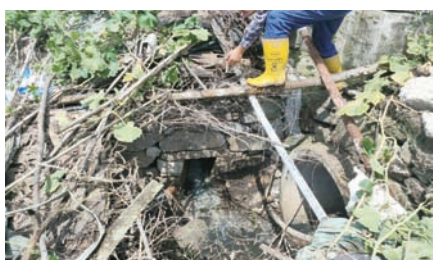
雨水排口有污水排出
