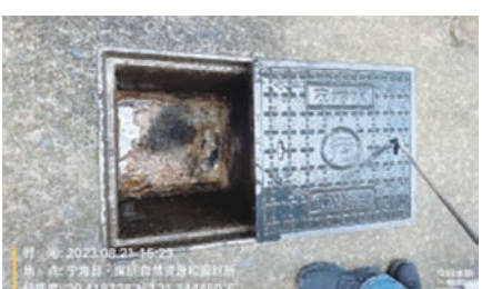
污水井严重堵塞
