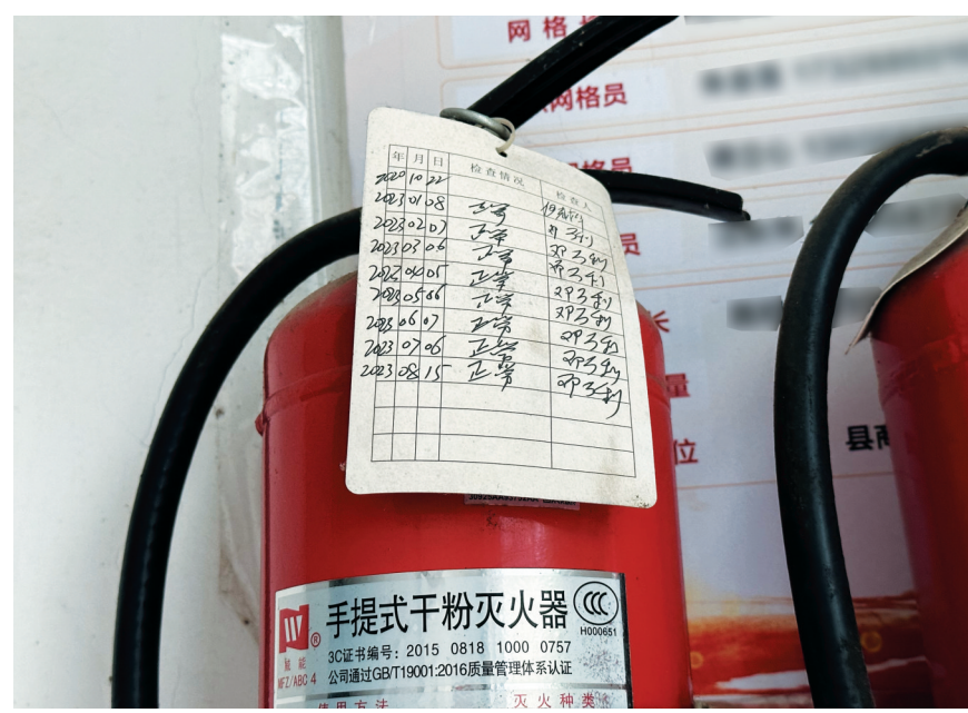
富安嘉苑小区的消防器材月检卡最后一次检查时间为2023年8月。
