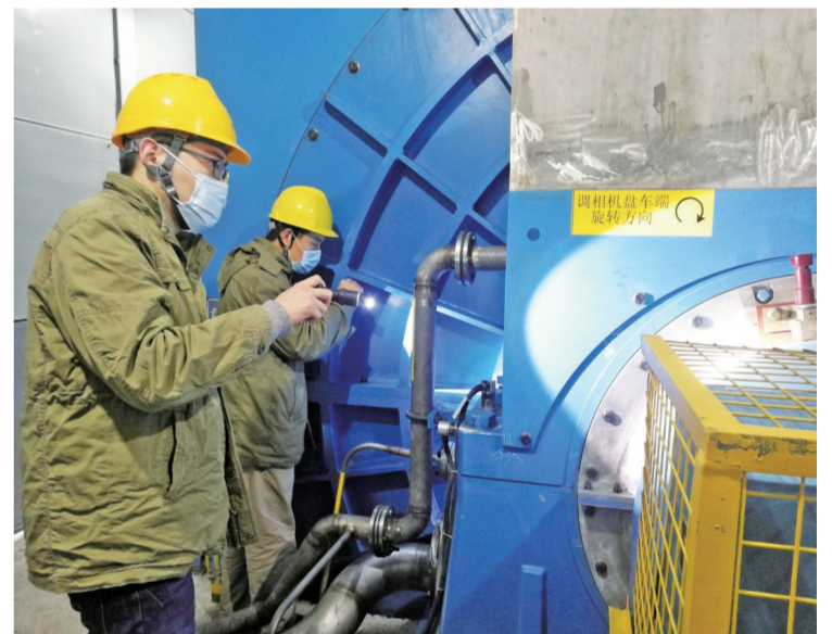
1月22日,江苏方天电力技术有限公司员工正在±500千伏换流站内巡检调相机主机区域。 殷翔 摄
