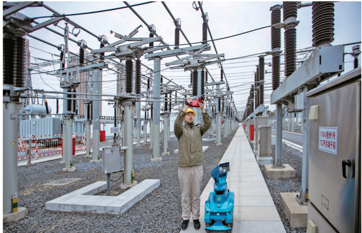
1月21日,农历除夕,泰州220千伏变电站内,运行值班人员正和智能巡检机器人一起巡查。 汤德宏 摄
