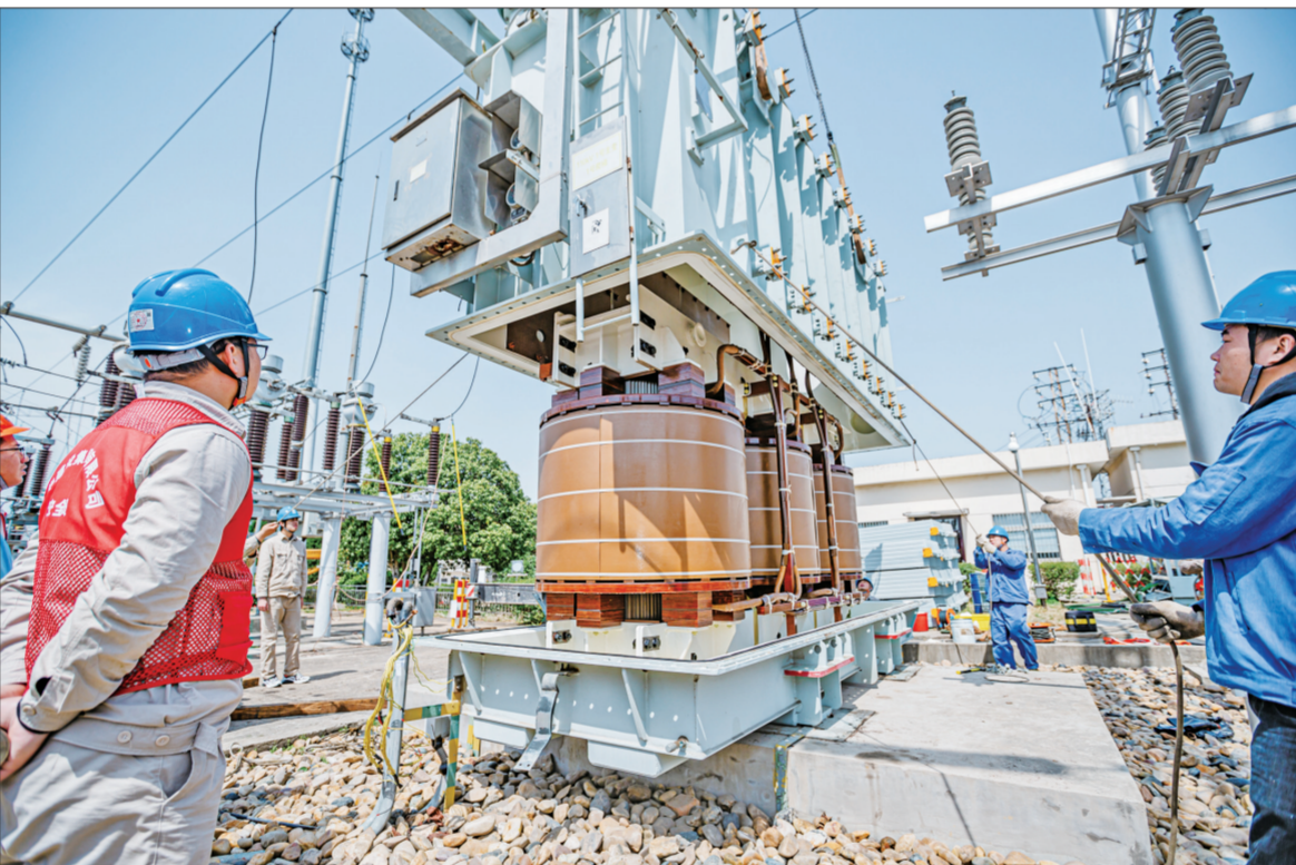
3月26日,国网南京市溧水区供电公司组织对溧水区110千伏洪兰变电站1号主变实施吊罩大修,消除设备潜在隐患,提升设备健康水平。朱博闻 摄文
