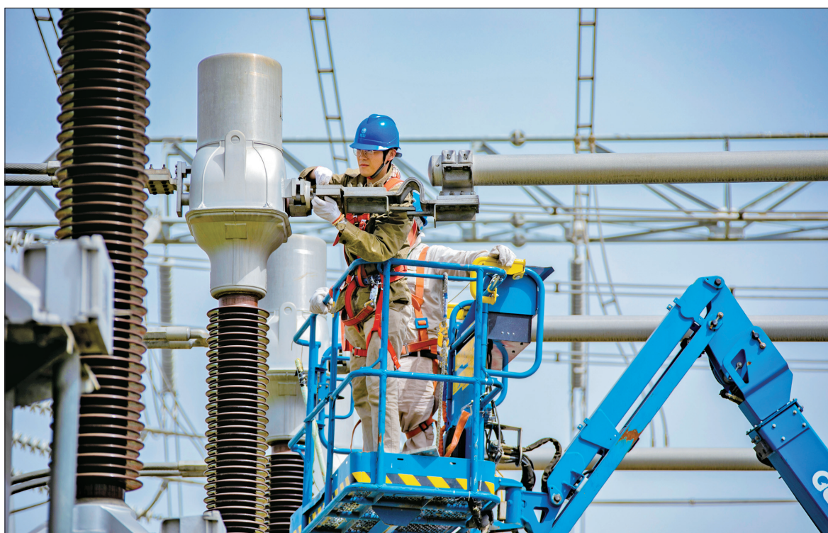
4月14日,国网淮安供电公司自主更换了500千伏安湖变电站内绝缘异常的一组220千伏电抗互感器,及时消除了设备隐患,为迎峰度夏电网安全稳定运行增添了一份保障。 陈妍 撰文
