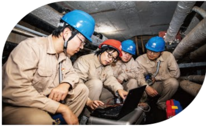
国网江苏电力何光华劳模创新工作室团队成员在红旗变电站隧道内进行故障探测。 许阳 摄
