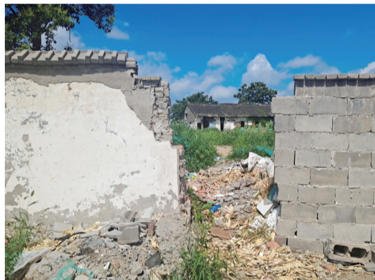
时间:7月1日 地点:益民路大渔池菜市场周边 存在问题:拆迁工地围墙破损 责任单位:住建局
