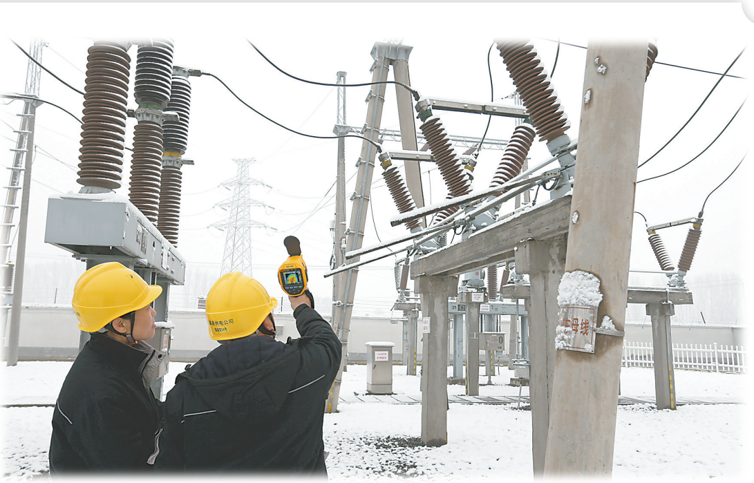
一场春雪普降古温大地，气温骤降。1月5日，国网温县供电公司组织运维检修部、各供电所人员分片包干对辖区供电设备和线路进行巡视检查。图为该公司运行人员对110千伏温县变电站进行巡视测温，及时消除安全隐患，为县域群众安全用电、温暖度冬保驾护航。 李云霞 闫杜娟 摄
