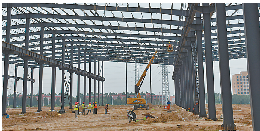
日前,孟州市巨力索具科技产业园项目施工现场,工人在加紧搭建钢结构厂房。该项目位于孟州高新技术产业开发区,项目总投资10.8亿元。项目全部达产后,每年可新增销售收入10.8亿元、利税3.3亿元。赵春营 摄
