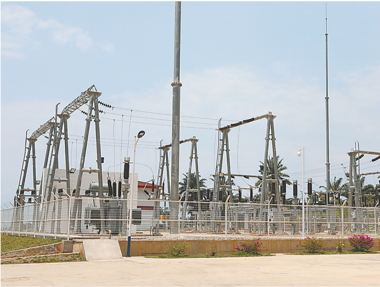
▶10月30日在布隆迪鲁蒙盖省鲁齐巴齐村拍摄的鲁齐巴齐水电站升压站。 中国援建的布隆迪鲁齐巴齐水电站最后一台机组于今年7月完成试运行,电站三台机组当月实现并网发电目标。水电站的建成对提高当地工业生产,促进国民经济发展,改善居民生活水平等起到重要作用。 新华社记者 董江辉 摄 (新华社发)
