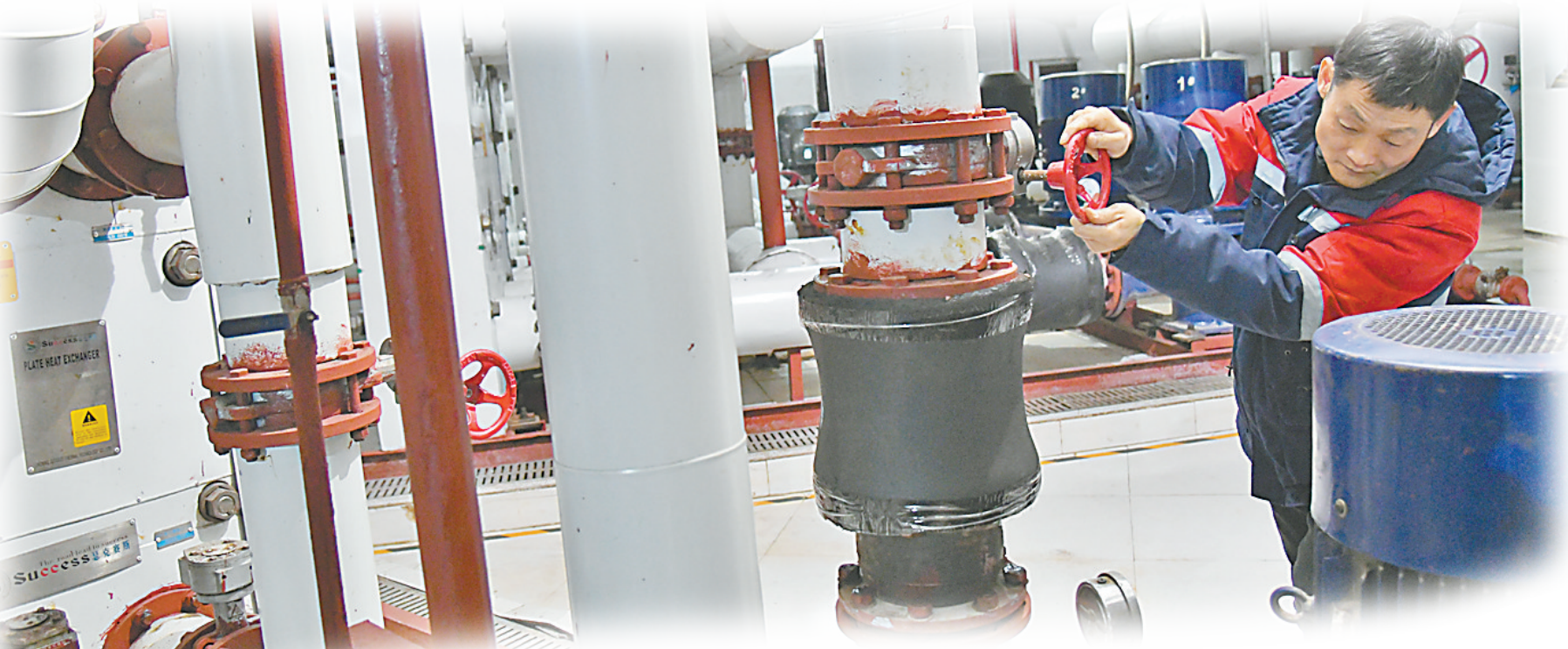
中环寰慧(焦作)节能热力有限公司工作人员在开启供暖设备。 本报记者 翟鹏程 摄
