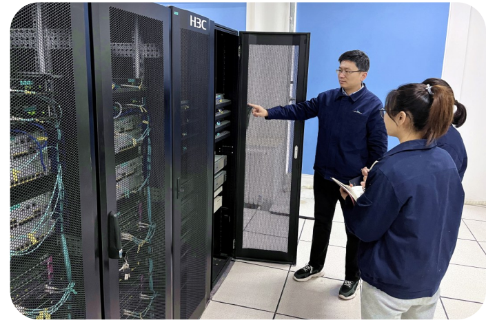
孙高阳(左一)在对设备进行巡视检查。本报记者杨仕智摄
