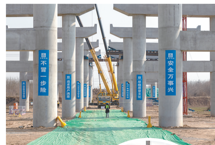
↑沿黄高速项目三标段南水北调特大桥加紧施工中。本报通讯员 张瑞红 摄
