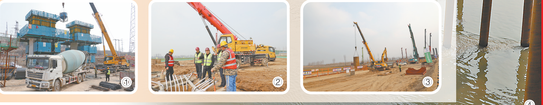
图① 沿太行高速大河大桥8号墩在进行空心墩墩身混凝土浇筑。 图② 沁伊高速公路项目一标段跨S237分离立交桥在加紧施工。 图③ 塔吊林立、彩旗飘飘，沁伊高速热火朝天的施工场面。本报通讯员 段玉明 摄 图④ 2月16日，由中交二航局承建的沁伊高速公路黄河特大桥钢栈桥全线贯通。 本报通讯员 段玉明 摄
