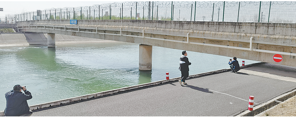
连日来,马村区交通运输局聘请专业检测机构,对辖区34座桥梁开展常规安全检测,根据检测结果提出有针对性的养护维修建议及技术指导,并设置桥梁信息牌,确保桥梁安全畅通。图为专业检测人员在对南水北调渠上的一座桥梁进行安全检测。
