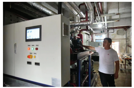
冷库技术人员24小时在岗,保障冷库运行安全。
