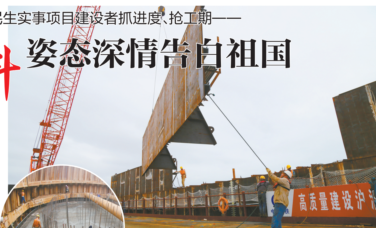
▲9月28日，崇启公铁长江大桥3号主墩四节钢围堰拼装全部完成。 ▲9月27日，崇启公铁长江大桥首个水中承台混凝土浇筑完成。
