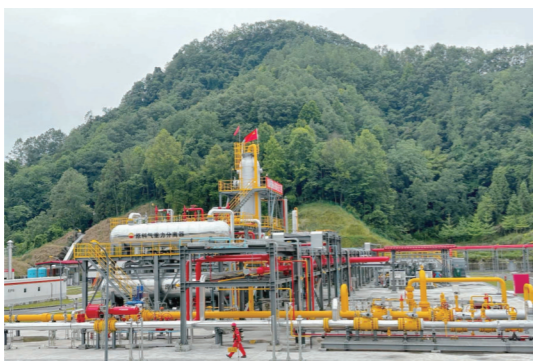
铁山坡脱水站(唐千惠摄)
