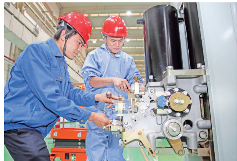
我区不断强化对口帮扶举措，加大资金投入，促进对口地区贫困人口就业脱贫。截至目前，今年共有145名西双版纳州建档立卡贫困人口来松转移就业。图为来自西双版纳的罗文明与王布都在正泰电气股份有限公司装配车间内忙碌。
