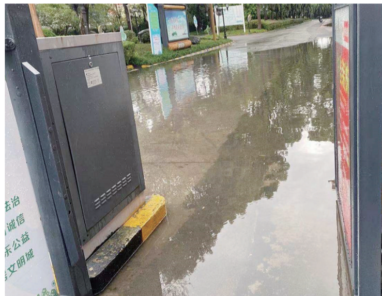
绿洲比华利花园小区门口积水严重。
