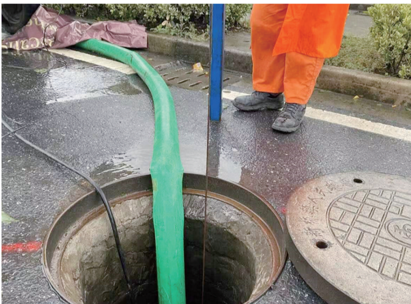
绿洲比华利花园小区外正在作业的排水泵。
