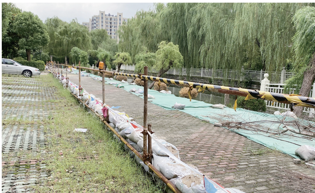
图为被护栏围起的润峰苑中桥港开裂护岸。
