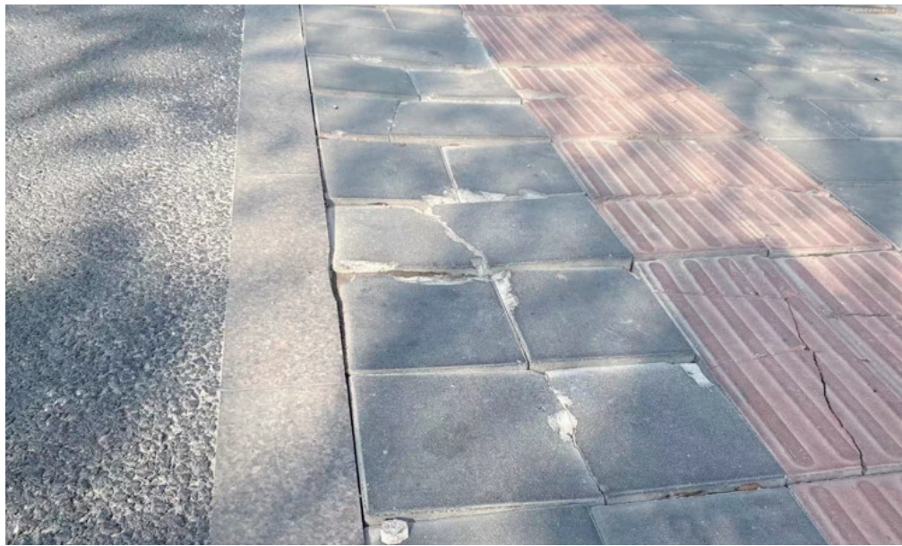
文涵路人行道上,人行道道板砖破损严重。 记者 张立 摄
