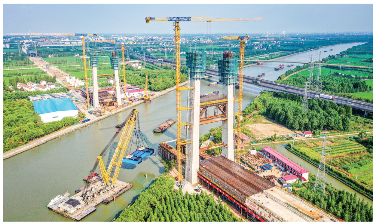
图为沪苏湖铁路上海段跨斜塘航道斜拉桥首片钢梁吊装现场。
