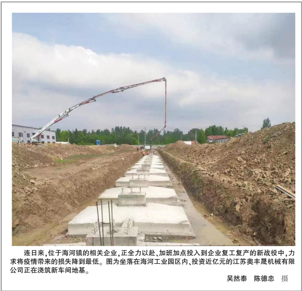
连日来,位于海河镇的相关企业,正全力以赴,加班加点投入到企业复工复产的新战役中,力求将疫情带来的损失降到最低。图为坐落在海河工业园区内、投资近亿元的江苏奥丰机械有限公司正在浇筑新车间地基。 吴然泰 陈德忠 摄
