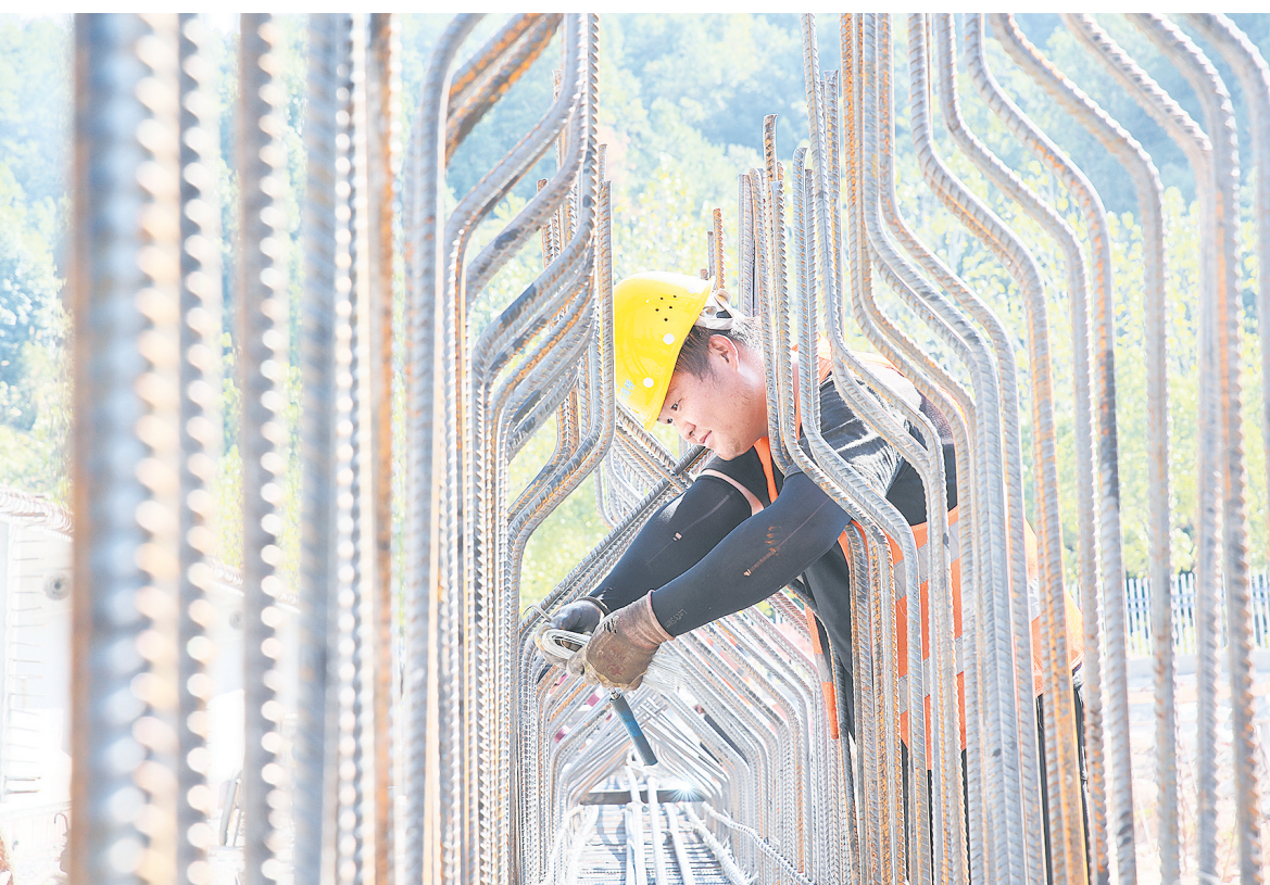
9月19日，大广高速公路修水南互通连接改造提升工程施工人员正加紧施工作业。该项目位于宁州镇湘竹村，总投资约1.6亿元，起点修水南互通匝道，终点与宁红大道相接，全长约6.5公里。截至目前，工程已完成项目进度50%以上。（记者 王江明 摄）
