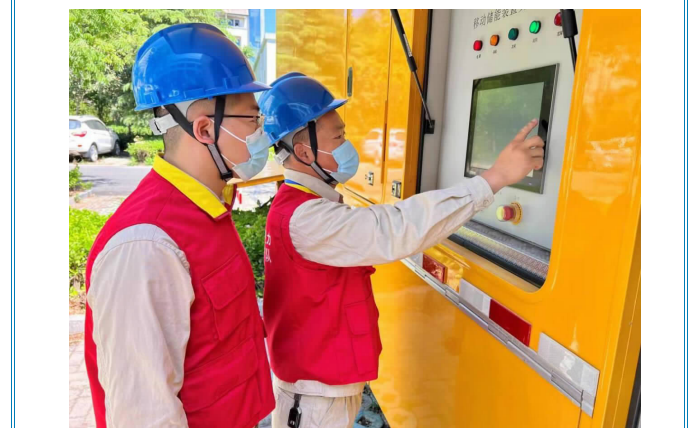
连日来,国网响水县供电公司变电人员密切关注高考期间天气情况,备好抢修车辆、物资等,严格执行24小时应急值班制度,坚定走在“陪考”路上,为高考考生追梦路保驾护航。 通讯员 张德富 摄
