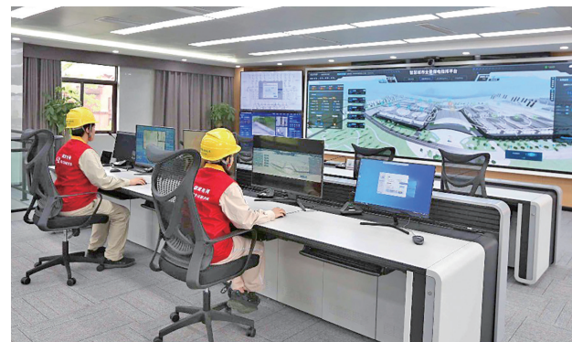
110千伏沙沟变电站内的智慧保电系统
