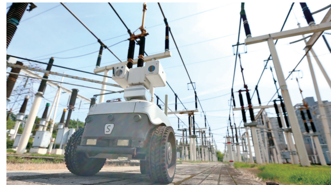
机器人在变电站开关场内巡视
