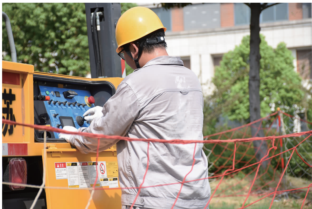
▲在新城镇新北花苑10千伏花园1号131线049号杆处,国网仪征市供电公司不停电作业分中心作业人员带电安装开关桩头护套,防止鸟类搭窝造成安全隐患。
