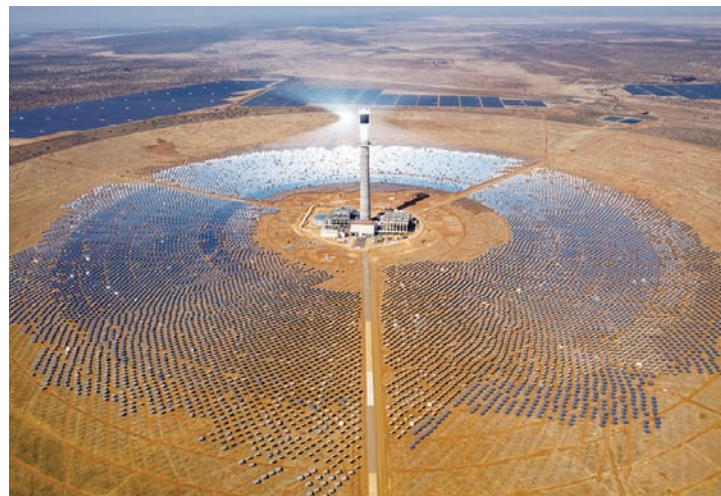
这是2024年8月20日在南非北开普省拍摄的由中国电建集团山东电建三公司承建的南非红石100兆瓦塔式熔盐光热电站项目(无人机照片)。该项目是撒哈拉以南非洲首个塔式熔盐光热电站项目，也是南非最大可再生能源投资项目之一。新华社发
