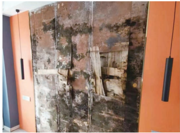
图为陈先生家的主卧墙面发霉严重。记者 帅莹 摄
