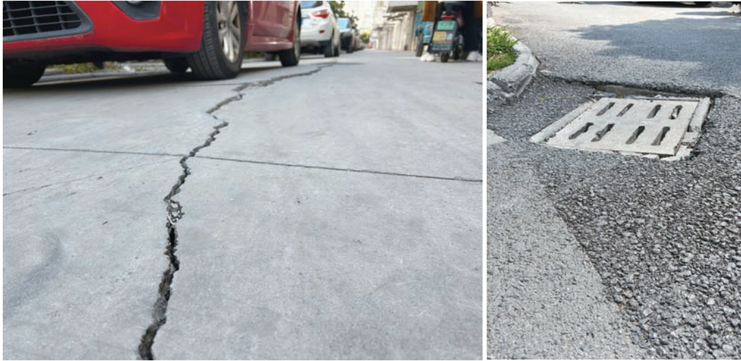
左图为路面开裂;右图为窨井下沉,路面不平整。 记者 帅莹 贺丽华 摄
