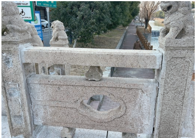
图为开裂的护栏。 记者 贺丽华 帅莹 摄
