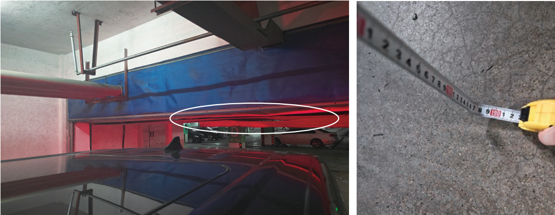
左图为防火卷帘门刮蹭了车顶“鲨鱼鳍”；右图为记者测量防火卷帘门离地面高度。记者 马骏 摄
