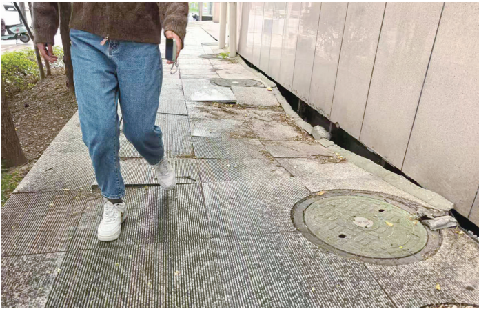
图为路面一段出现下陷情况。记者 王丹 摄
