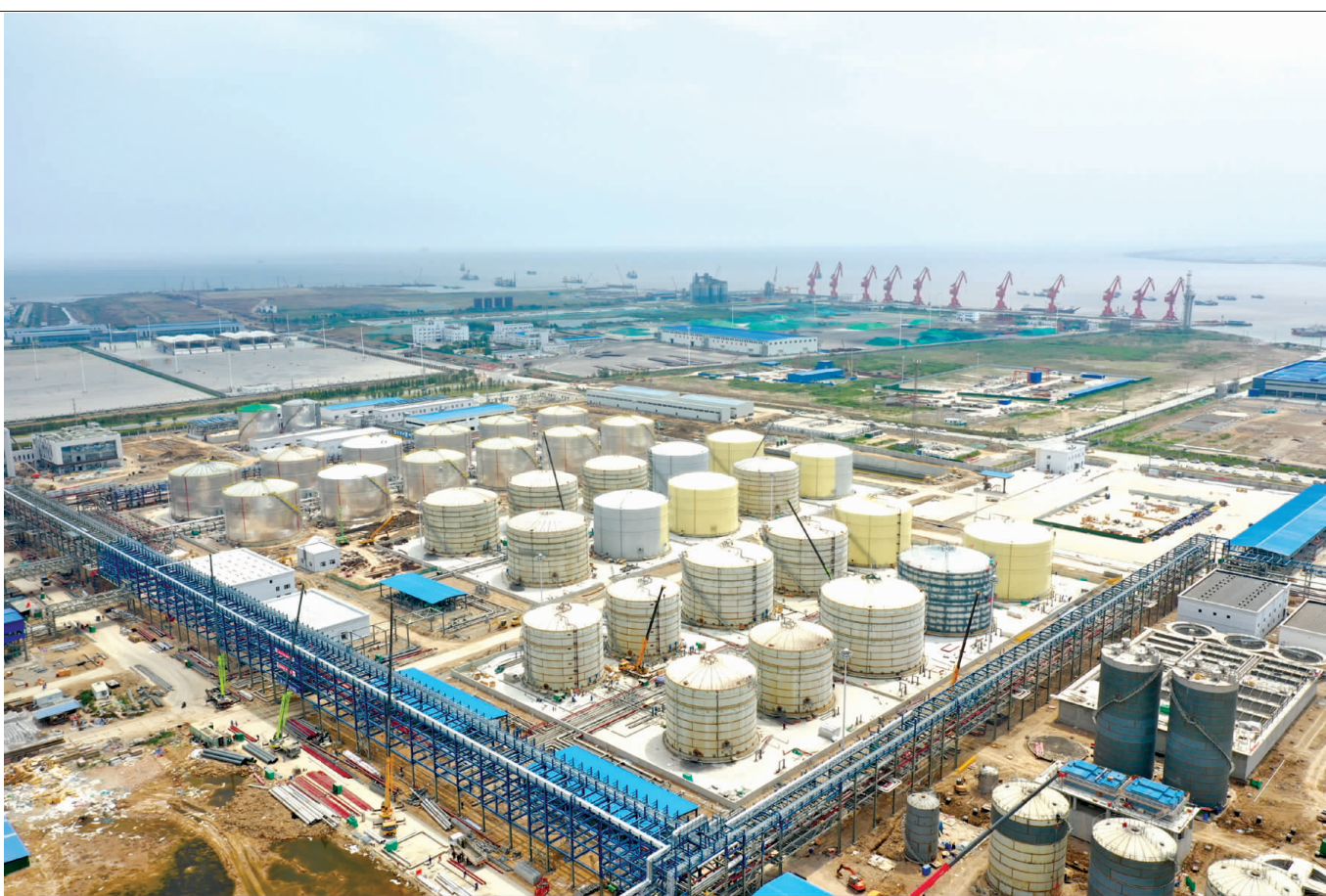
12日,县临港产业区连云港嘉澳生物航煤项目110kV变电站成功送电,为下一步系统联调、联动试车奠定了坚实的基础。该项目总投资约168亿元,于去年1月份开工建设,计划今年内建成投产。项目分四期建设,一、二期达产后可实现年销售收入159亿元、净利润33亿元。
