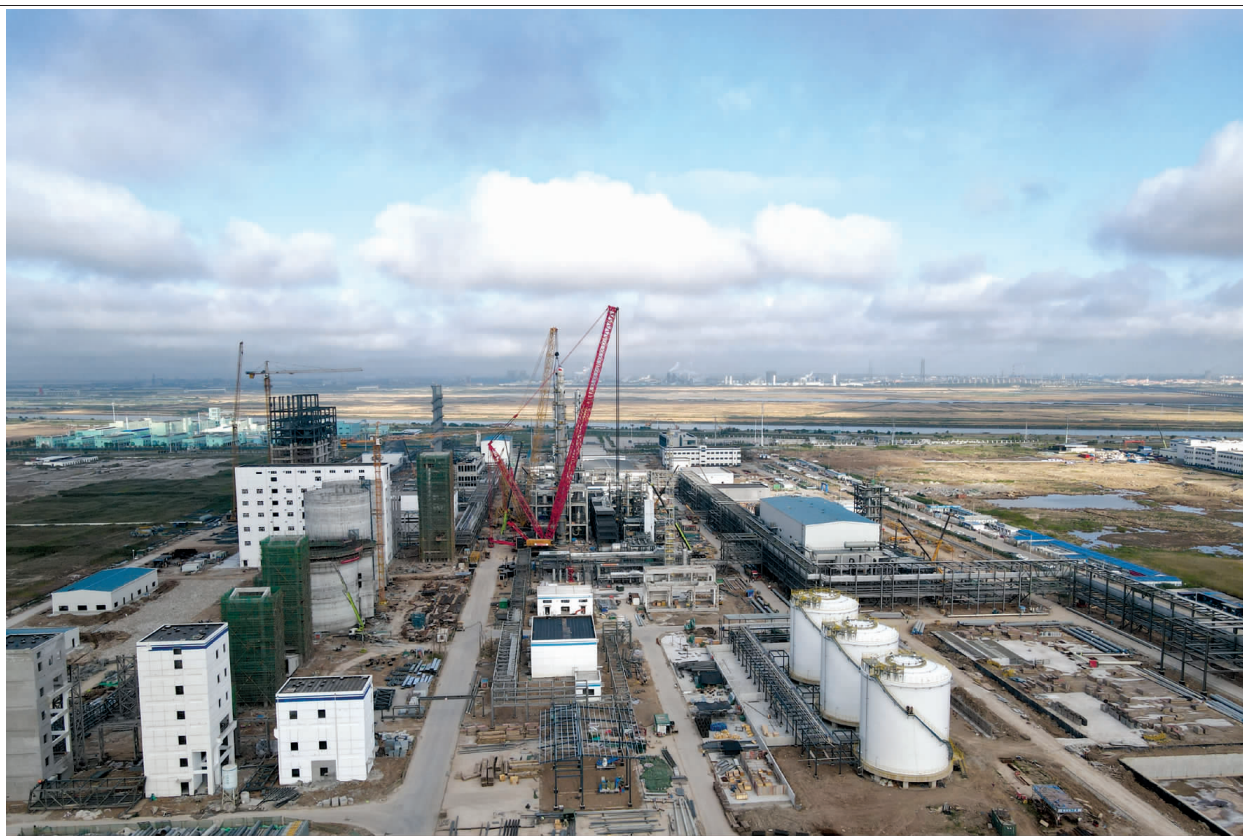
近阶段，连云港碱业公司搬迁升级改造项目现场储罐高耸、装置林立、管廊交错，近3000名建设者奋战在施工一线，全力以赴加快推进管道及仪电设备安装工程，力保按计划三季度全面联动调试，四季度投料试生产。
