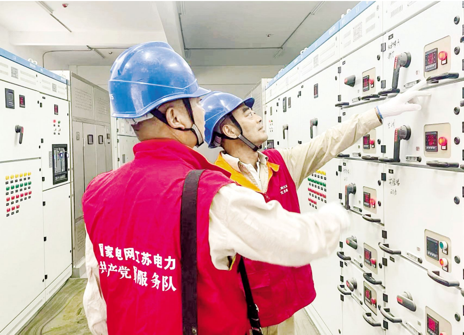
日前,为保障学校开学供电平稳、安全、有序,国家电网淮安供电公司各个学校的电力设备进行实时巡查,消除用电安全隐患,为学校如期开学做准备。
