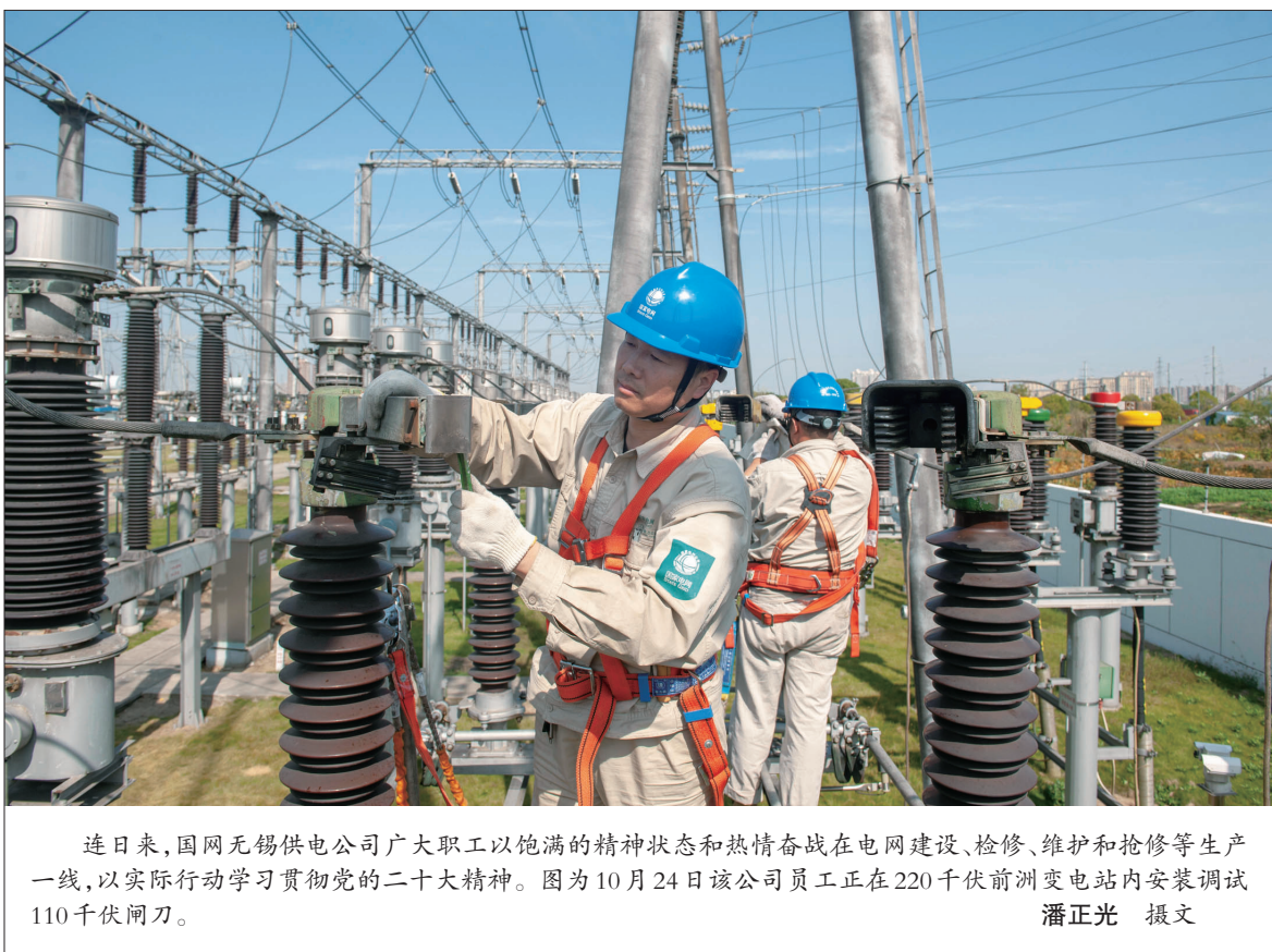
连日来,国网无锡供电公司广大职工以饱满的精神状态和热情奋战在电网建设、检修、维护和抢修等生产一线,以实际行动学习贯彻党的二十大精神。图为10月24日该公司员工正在220千伏前洲变电站内安装调试110千伏闸刀。潘正光 摄文
