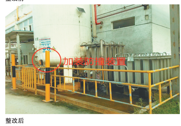
整改前 整改后
