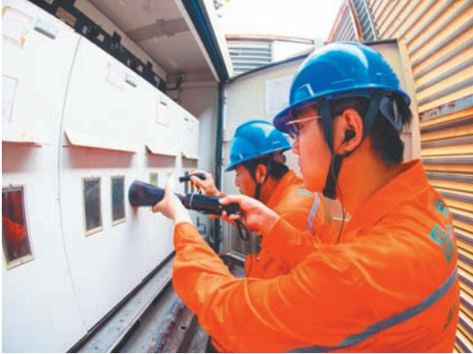
对比赛场馆用电涉及的环网柜等设备开展局部放电检测
