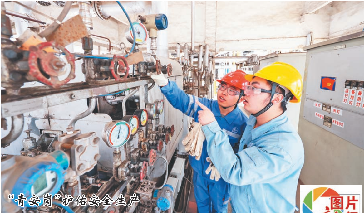
连日来，扬子石化芳烃厂组织“青安岗”安全员深入一线，重点围绕安全警示标识、工艺安全风险防控、设备泄漏管控、装置检修过程管控等8大重点领域进行隐患排查，加强生产过程和直接作业环节监督。图为“青安岗”安全员在排查制苯装置大机组隐患。 裴军 匡文静 李树鹏 摄
