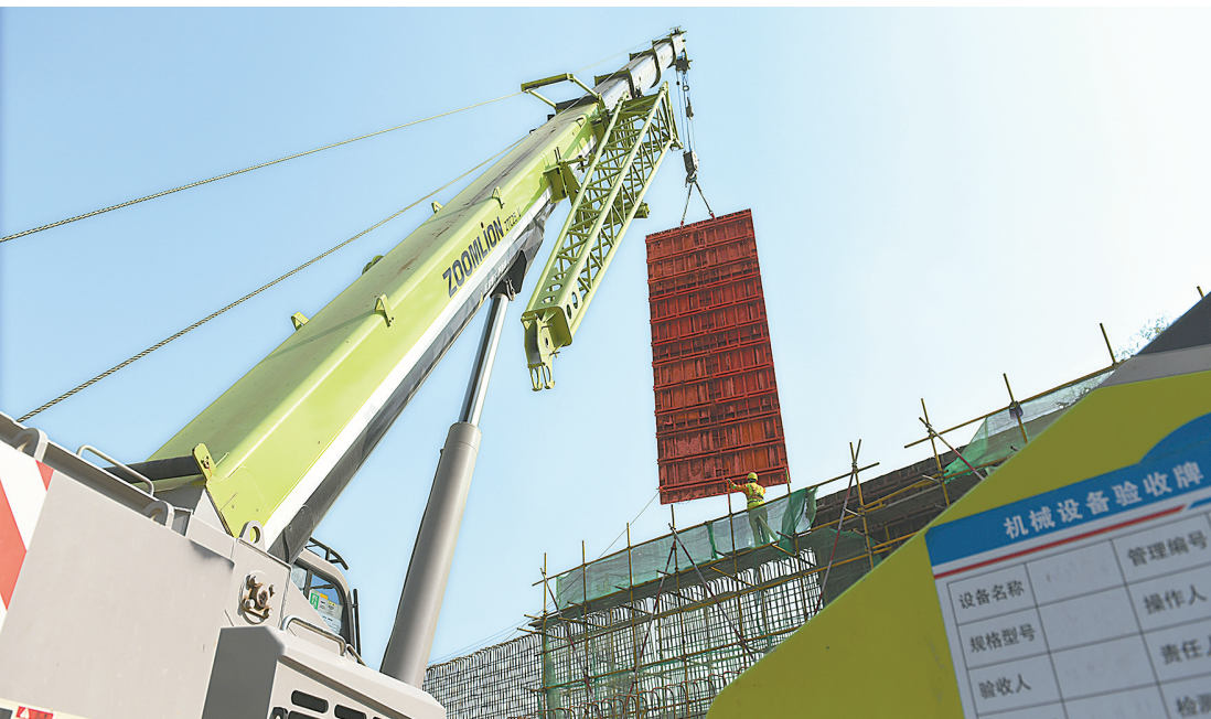
4月1日,市东海大道建设项目1标段施工现场机械轰鸣,一派繁忙的建设场面。市投资集团有限公司督导参与东海大道建设项目的各标段尽快复工复产,目前,该项目3个标段的施工队均已重返建筑工地开始施工,力争把耽误的工期赶回来。 本报记者 刘金元 摄
