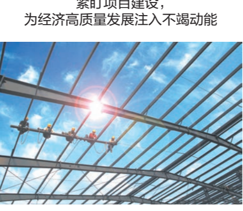
奋安铝业年产10万吨高端工业铝型材项目建设紧锣密鼓。许萍 摄
