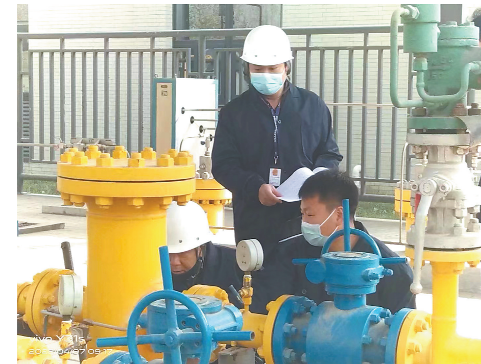
日前,示范区质监分局要求特种设备生产、使用企业严格落实安全生产主体责任,对特种设备生产、使用企业开展安全大检查。图为该局执法人员在一公司进行车载压缩气充装站年度审查。
