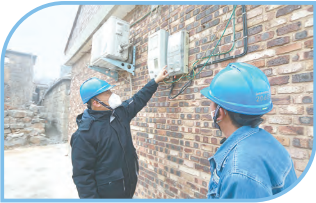
检查空气开关。
