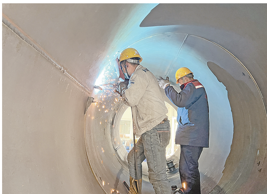
2月12日,华锐科技(河南)有限公司工人正在生产产品。该公司位于修武经济技术开发区西片区,是一家装配式建筑智能设备研发、生产、销售于一体的科技型企业。正在建设的年产900台(套)装配式建筑机械智能设备项目全部投产后,年可实现销售收入18亿元、利税1.6亿元,提供就业岗位250个。 本报记者 宋崇飞 摄
