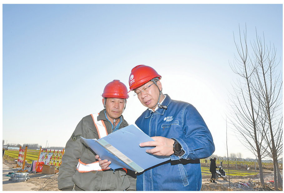
聂峥（右）在电力工程施工现场开展安全督查。 (本报资料照片)
