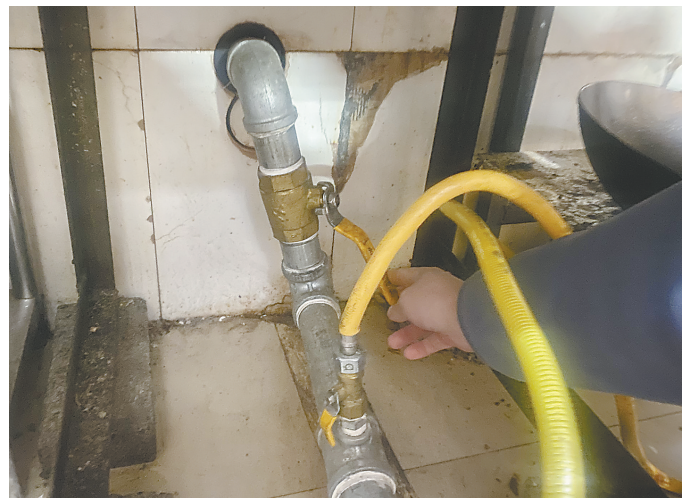
月季农贸市场一分利美食店改造后的天然气管道设施。本报记者 高小豹 摄
