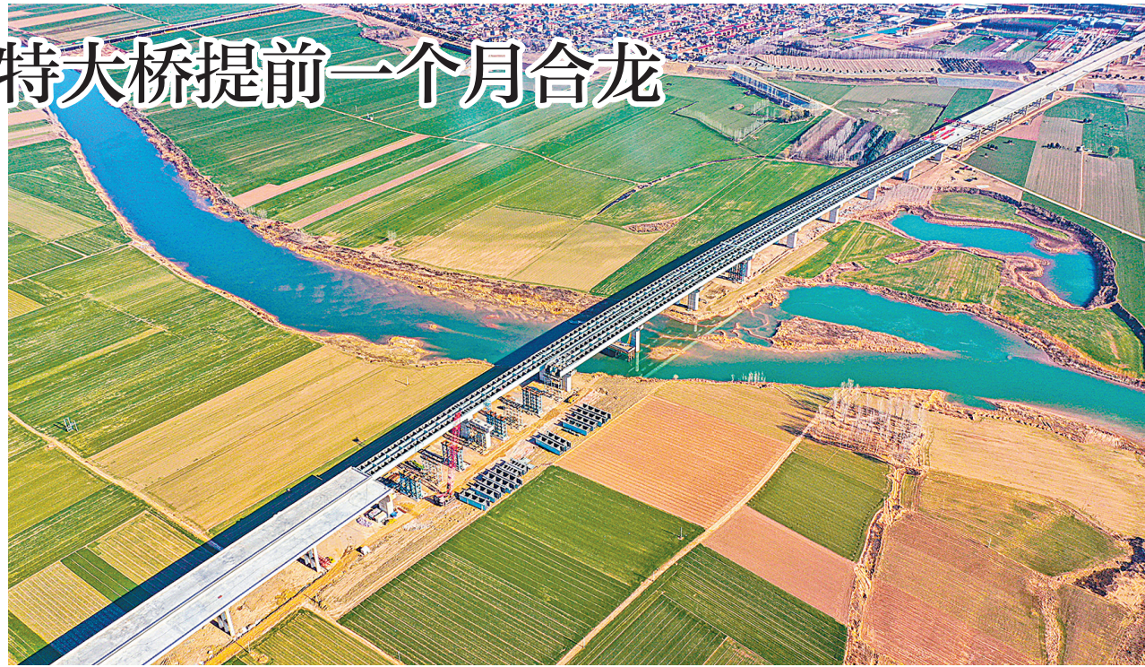
12月21日，由中交路建承建的沿黄高速沁河特大桥施工现场，工人们将2560吨重的钢梁稳稳顶推至两座墩柱之上。至此，沁河特大桥主桥钢梁顶推合龙比原计划提前一个月完成。图为项目施工现场。 本报记者 刘金元 摄
